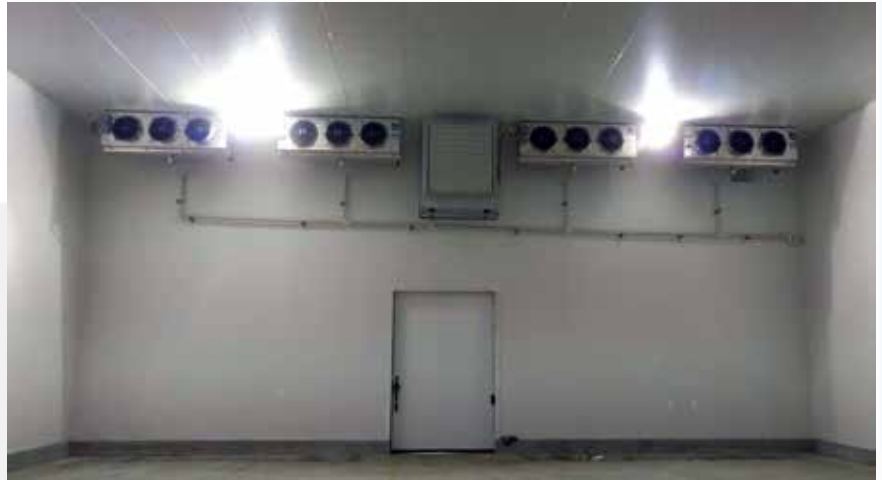
Foto 1. Câmara Frigorífica para Batatas (vista interna).
